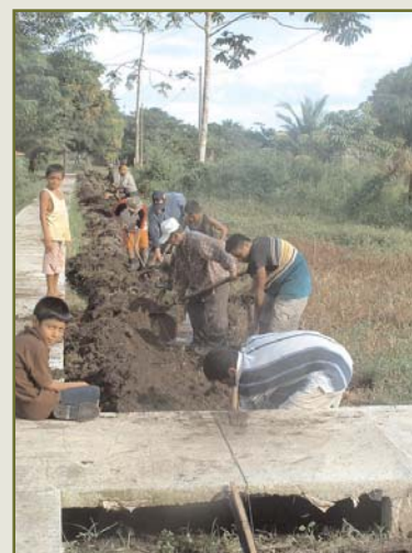
Septiembre 2003. Pobladores de San Juan del Norte acometen el zanqueo de las calles como parte de la contrapartida de la población a las obras.
